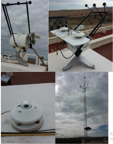
Equipos de la Estación solarimétrica Zacatecas_04 SSM
